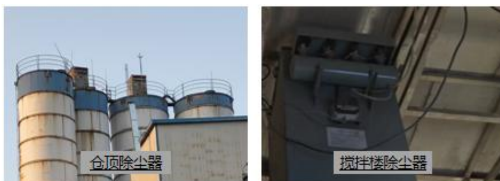
图 3-1 项目除尘设备照片
