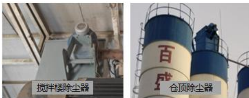
图 3-1 项目除尘设备照片
